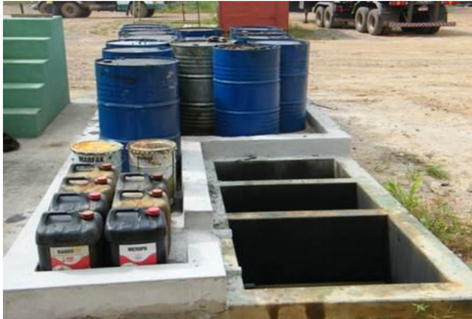
Figura 23- Filtro separador de água e óleo.
