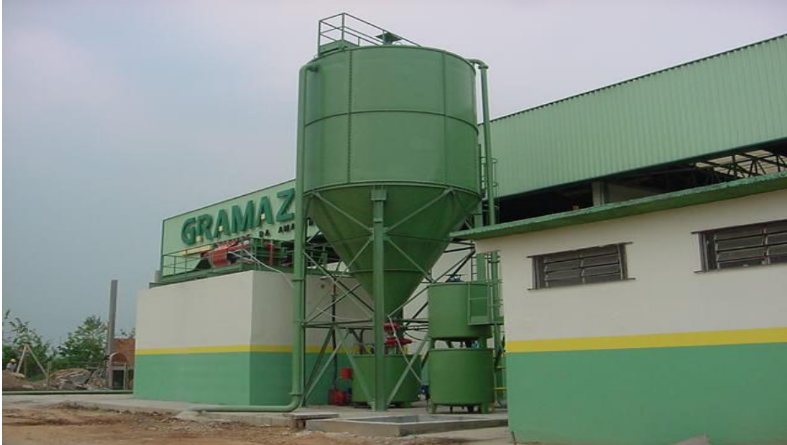
Figura 14- Filtro Prensa utilizado para no tratamento dos resíduos líquidos.
